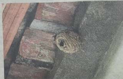
Nido de velutina en una vivienda en Cambados.
